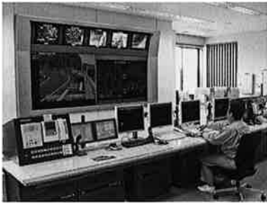
写真2 中央監視制御装置
